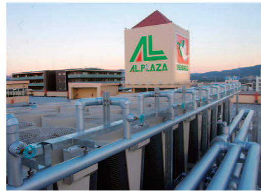
アル・プラザ京田辺の空調熱源を高効率型に更新
